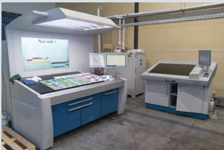
В феврале в «ЛюксУпак» закончился монтаж четвертой по счету печатной офсетной машины большого формата. Модель сложная, в уникальной конфигурации специально для печати премиальной упаковки
